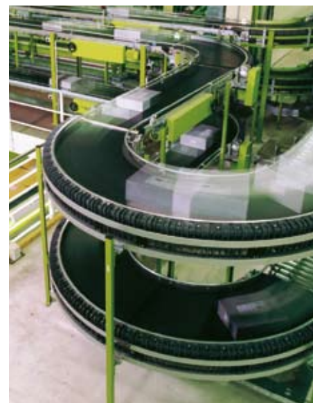
Transportador de banda curva en un centro de distribución.
